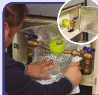
Contadores de agua y tapas de cuadros
