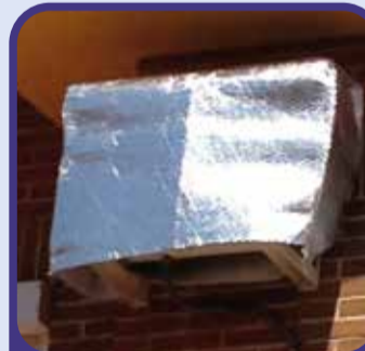
Equipos de climatización
