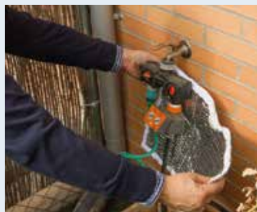
3 Contadores de agua
